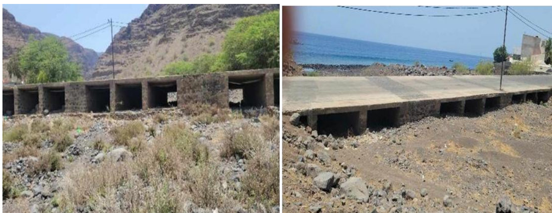
Figura 20: pontes de correção para auxiliar na contenção de sedimentos e na gestão do fluxo de água. Fonte: Elaboração própria.
